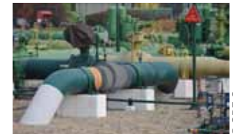
Site de stockage de gaz naturel d'Etrez (01)
